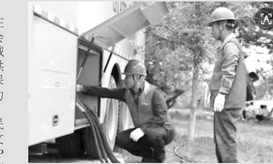
保电人员检查应急发电车设备。 际制定专项保电方案和应急处置预案,将各项保障责任分解落实到具体岗位。 活动启动前,该公司保电工作组对侍郎湖景区主供线路和全部配电设施开展拉网式排查,逐一核验舞台供电回路与临时接电设备的运行状
