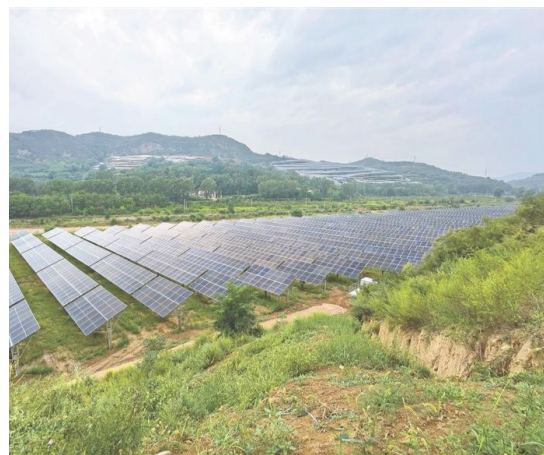
近日,在中能建投陇县10万千瓦光伏发电项目区,一排排光伏组件整齐排列。李静茹 摄
