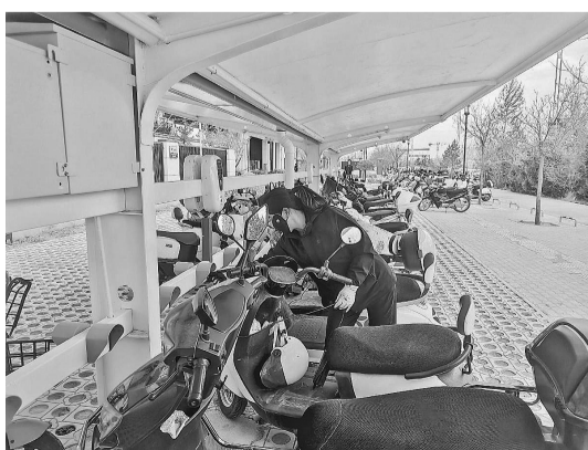
居民在小区充电车棚内为电动自行车充电。
